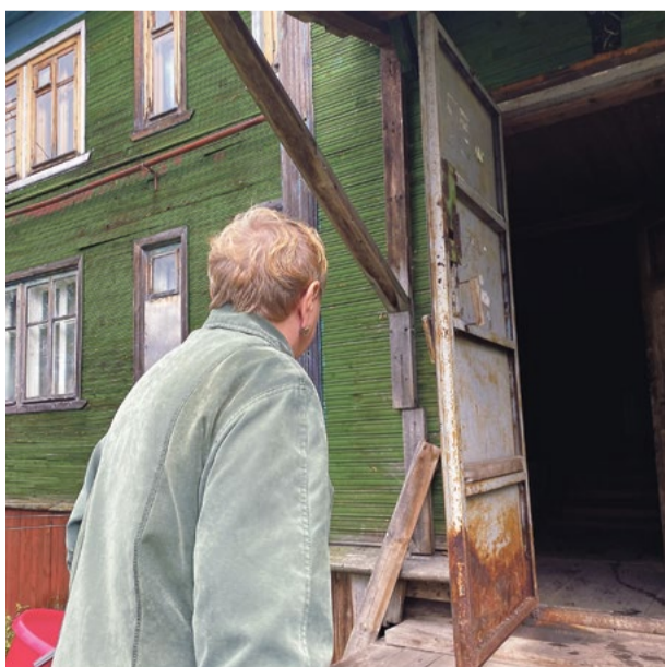
Этот дом, по словам администрации города, был недавно отремонтирован. Однако жильцы всё так же жалуются на протекающую крышу
