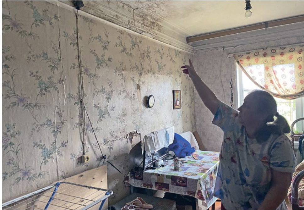
Потолки в квартирах пестрят следами от подтёков
