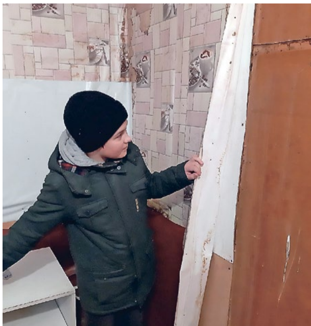
Обои в «новом» доме отстанут от стен
