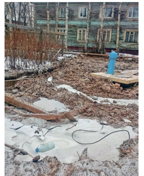
За колонкой не засыпана канава с водой, в ней лежит кабель под напряжением
