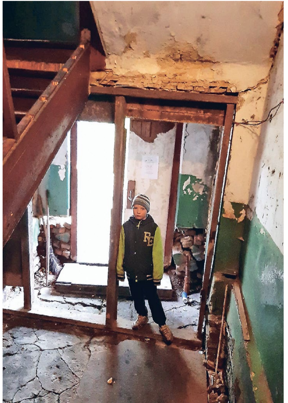
Потолок в подъезде подпирает деревянная балка
