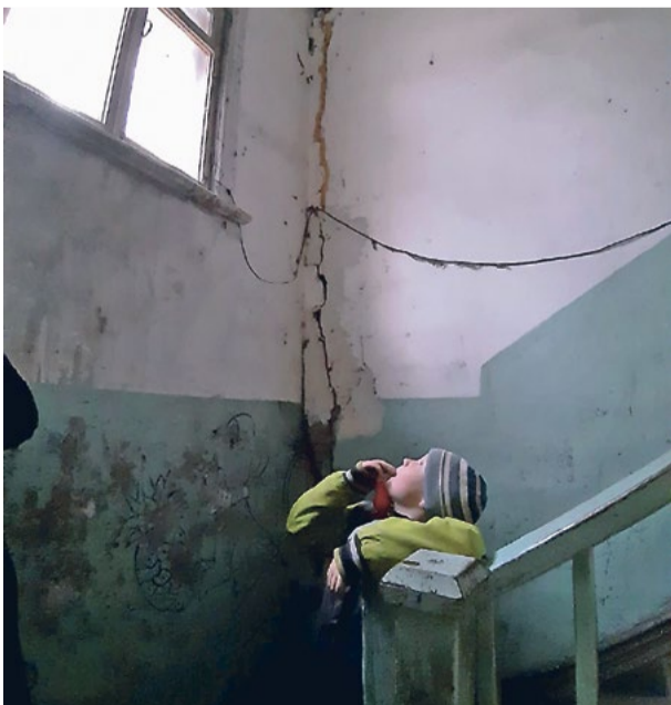
На голову постоянно сыплются куски штукатурки
